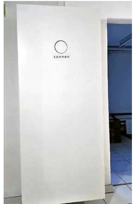
Ein Batteriespeicher im Haus erhöht den Anteil an der Eigennutzung des erzeugten Solarstroms merklich. Foto: Gaby Blum
